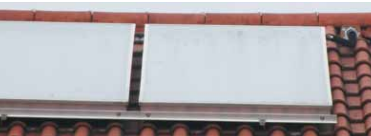
Solaranlage für Warmwasseraufbereitung.
